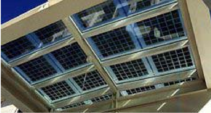
Saçaklarda güneş pili uygulaması
